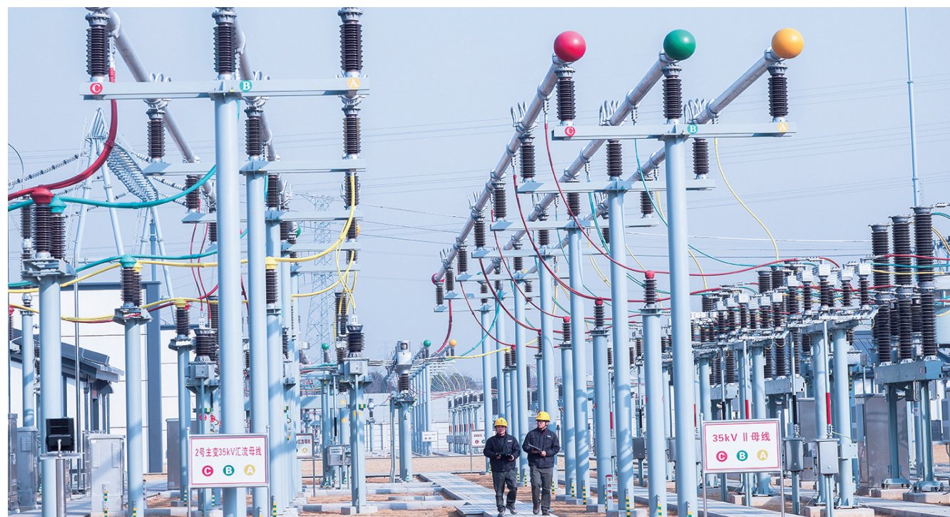
1月21日,在长兴500千伏输电工程长兴变电站,工作人员巡查设备运行情况。 当日,位于浙江省湖州市长兴县的长兴500千伏输电工程正式竣工并网投产,这是2025年浙江电网投产的首个超高压工程。 长兴500千伏输电工程是浙江重点能源项目,变电容量200万千瓦安,年供电量可达70亿千瓦时。 [新华社记者 徐昱 摄]
