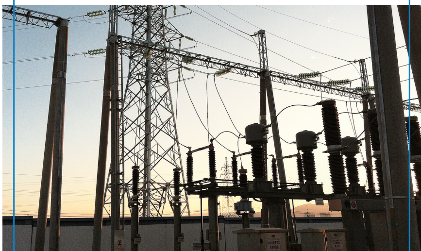
骨干电网:220千伏变电站
