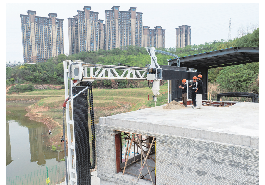
4月9日拍摄的3D打印机建设的双层小楼(无人机照片)。近日,在湖北宜昌三峡大学3D打印研发基地试验场,一栋由学校自行研发的12米级龙门式建筑3D打印机建设的双层小楼实现封顶,目前正在进行斜坡屋顶的施工安装。这栋双层小楼高8米,占地100平方米,比传统建造工期缩短约70%,打印的效率和完整性达到预期效果。【新华社记者 肖艺九 摄】
