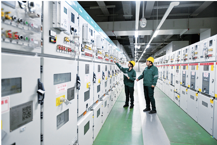
4月15日，国网雄安新区供电公司工作人员在剧村220千伏变电站设备室内记录设备运行参数。
