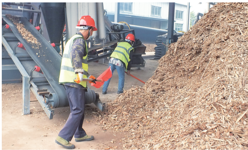
龙街镇新建的生物质颗粒燃料生产线正在运作。(摄于9月15日)
