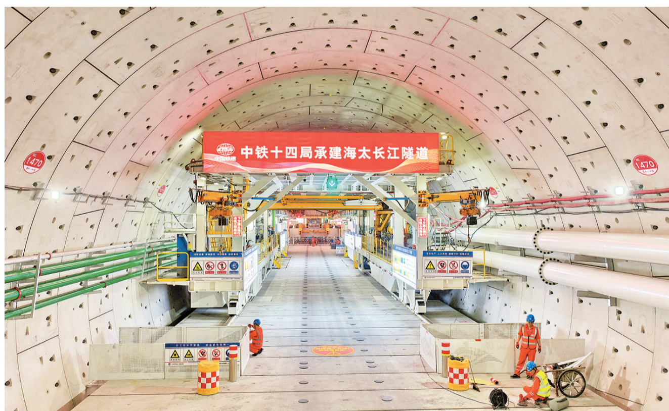
12月7日在江苏省南通市海门区拍摄的海太长江隧道工程施工现场(无人机照片)。近日,在江苏省南通市海门区,海太长江隧道右线隧道盾构掘进突破3000米,完成总掘进任务的近三分之一。海太长江隧道位于江苏省长江入海口区域,北起南通海门区,南至苏州太仓市,全长39.07公里,其中过江隧道长11.185公里。【新华社发(许丛军摄)】
