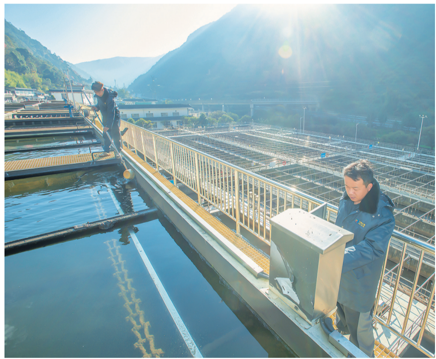
大理水务污水处理厂员工在察看高效沉淀池运转情况。(摄于1月2日) 该厂2015年投产，主要承担大理市中心城区生活污水处理任务，服务人口53万，采用先进工艺达标排放，为保护洱海作出了贡献。
