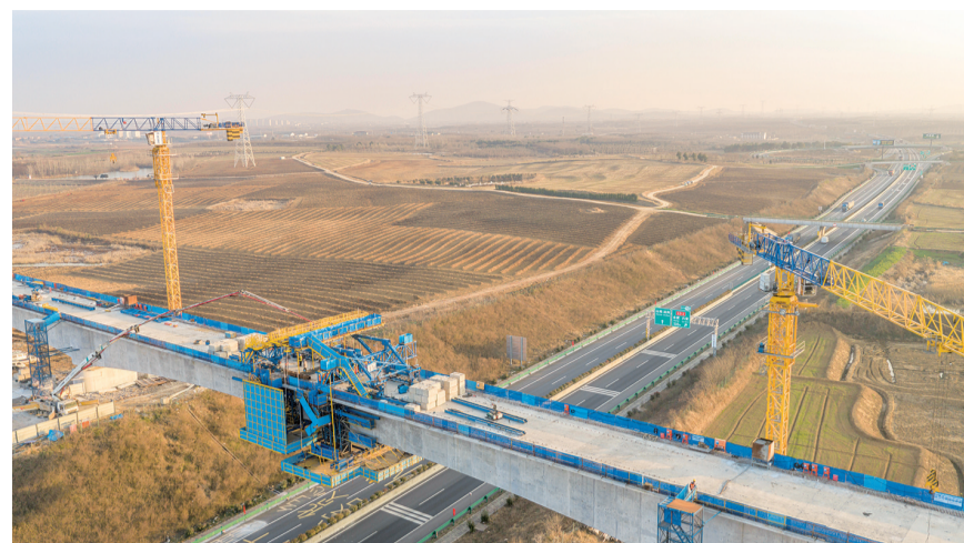
这是进行合龙施工的合武高铁庐安特大桥跨德上高速连续梁(1月12日摄，无人机照片)。
