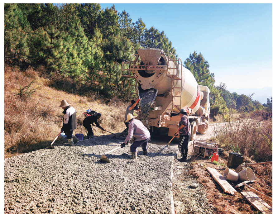
巍山县南诏镇河西村委会竹麻箐进村道路硬化正在施工中。(摄于4月1日)
