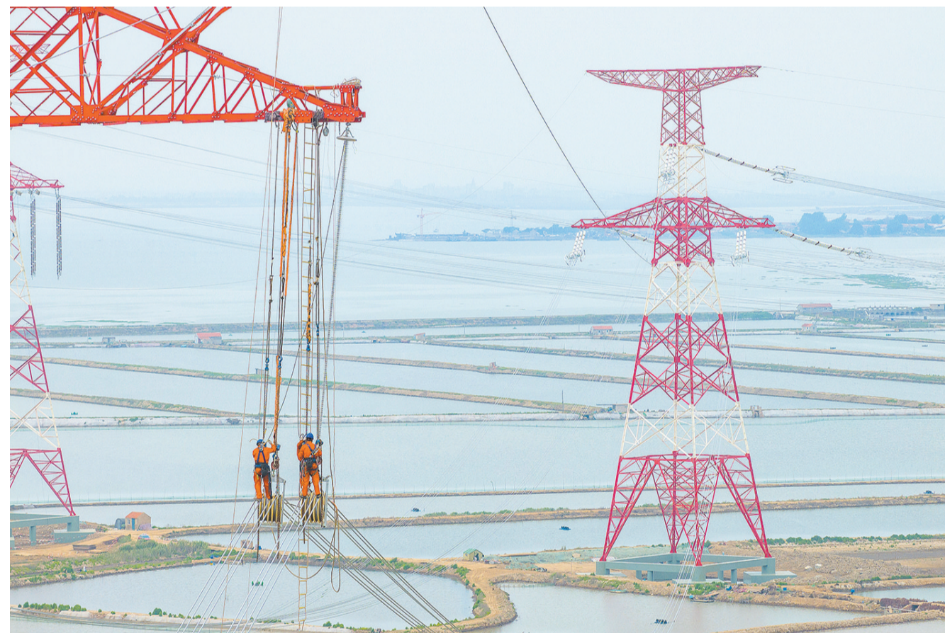
6月22日,在山东省海阳市辛安镇,山东送变电公司的工作人员在进行高空作业(无人机照片)。为保障山东海阳平安核电机组投运后的电力送出,山东首个服务核电站电力送出的特高压工程——1000千伏海阳平安核电送出特高压工程目前正在高空线路架线作业。据悉,该工程将与烟威1000千伏特高压交流输电工程一并接入山东电网,建成后为胶东半岛核电及海上新能源基地电力送出创造先决条件,助力能源转型和绿色发展。【新华社发(徐可 摄)】
