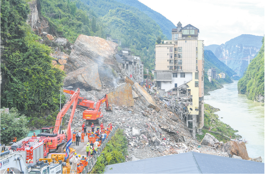
7月19日，救援人员在现场进行搜救。7月17日9时10分许，重庆彭水县汉葭街道发生一起山体崩塌，造成多人被埋失联。救援进入第三天，各方力量在现场全力加紧救援。现场救援指挥部按照“救人优先”的原则，细化救援方案，采取“机械掘进+人工排查”相结合的方式，抢抓黄金救援期实施救援。下一步，现场指挥部将研究制定巨石移除方案，进一步进行深层搜救。灾害发生后，当地对受灾点位周边群众采取分散安置、酒店集中安置等方式转移风险区人员，目前已安全转移周边群众1100余名。
