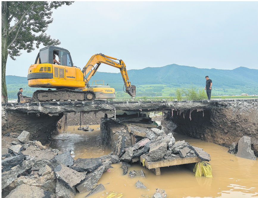
7月30日，在汪清县大兴镇，工作人员拆除损坏的路面。 7月29日，吉林省延边朝鲜族自治州汪清县出现强降雨天气，部分乡镇发生内涝，造成群众被困、道路损毁、供电中断等情况。强降雨过后，7月30日，汪清县交通、通讯、供电等抢修工作紧张有序开展。截至30日8时，全县已紧急转移9个乡镇的8145名群众。 【新华社记者 张楠 摄】
