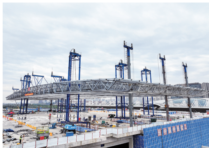
10月19日拍摄的新建上海至南京至合肥高速铁路南通站高架站房钢结构提升作业现场(无人机照片)。
